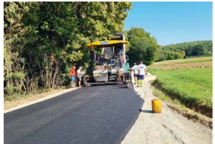
Die durch Starkregenereignisse verursachten Schäden, auf zahlreichen Gemeindewegen, wurden in den vergangenen Wochen wieder beseitigt.
