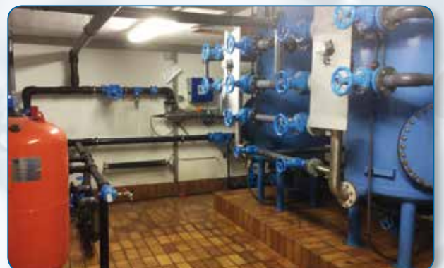
Aufbereitungsanlage Sand- und Aktivkohlefilter
